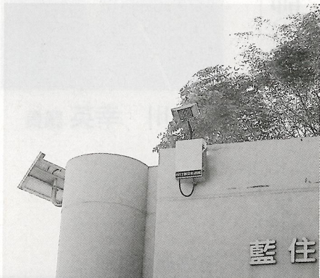
太陽光発電によるLED照明
