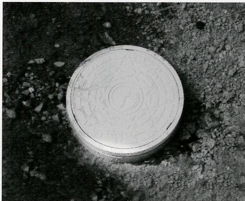
各家庭に設置している公共汚水ます
