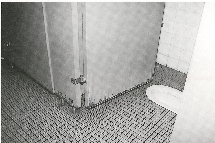
傷みが激しいトイレ（北小）
