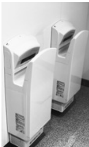
町民体育館に設置されている ハンドドライヤー
