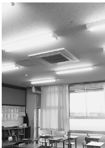
藍住中学校に設置されたエアコン
