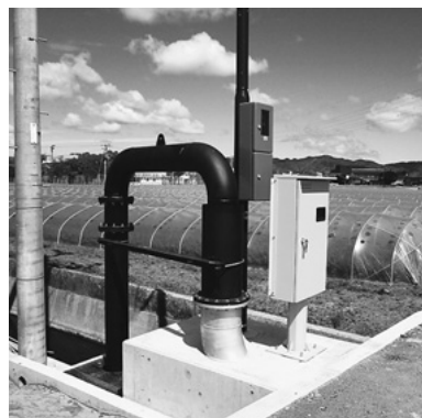
排水対策として設置されたポンプ
