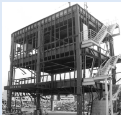
津波に襲われた防災対策庁舎
