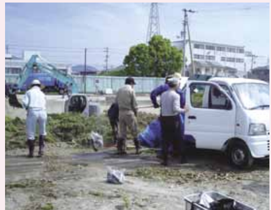
東中須の土砂仮置場にも大量の汚泥が持ち込まれました。
